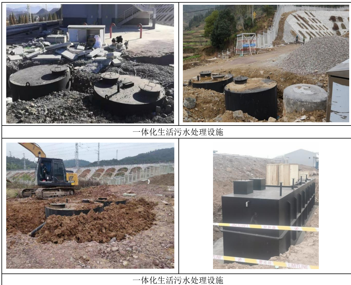
图 9.3-1 工程沿线车站一体化污水处理设施
